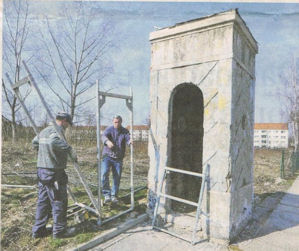
Jetzt geht es los: Bernd Richter (rechts) und Manfred Winkler haben gestern am Wachhäuschen Gerüste angebracht.
