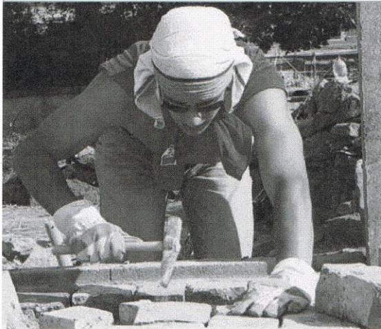
Stein auf Stein: Im Outfit eines echten Archäologen setzt Felix Kirsten eine Trockenmauer auf dem Gelände des ehemaligen Schlosses Döben. Foto: Frank Schmidt
